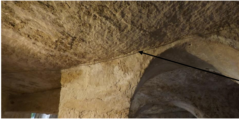
Figg. 4-5: differenza di inclinazione del soffitto in corrispondenza dei pilastri costruiti con blocchi sovrapposti
