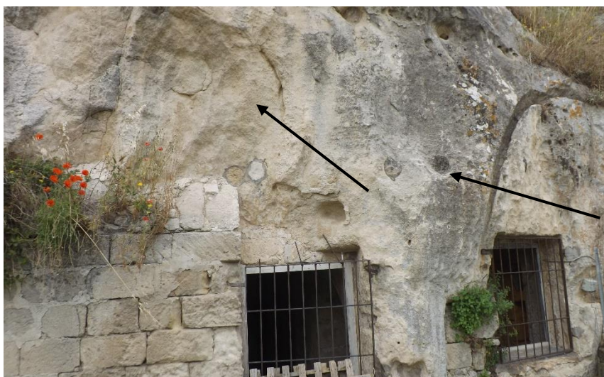
Fig. 7: profilo esterno dell'antico ingresso della Chiesa, con segni di crollo della parete esterna e di fori circolari
