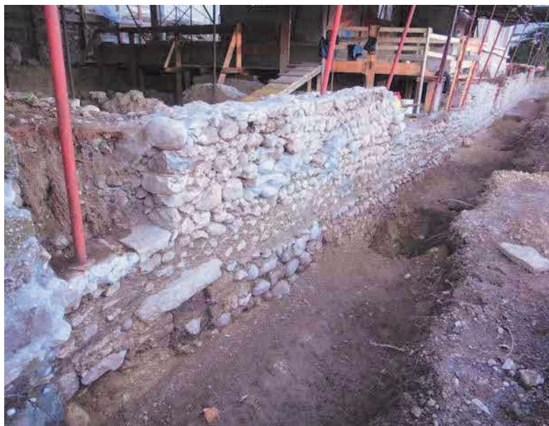
Fig. 5. Isera, villa romana. Il prospetto del muro perimetrale est della villa, messo in luce a seguito dello scavo di una trincea e alla contestuale demolizione di una struttura in cemento moderna che vi si appoggiava (foto B. Maurina, 2020).
