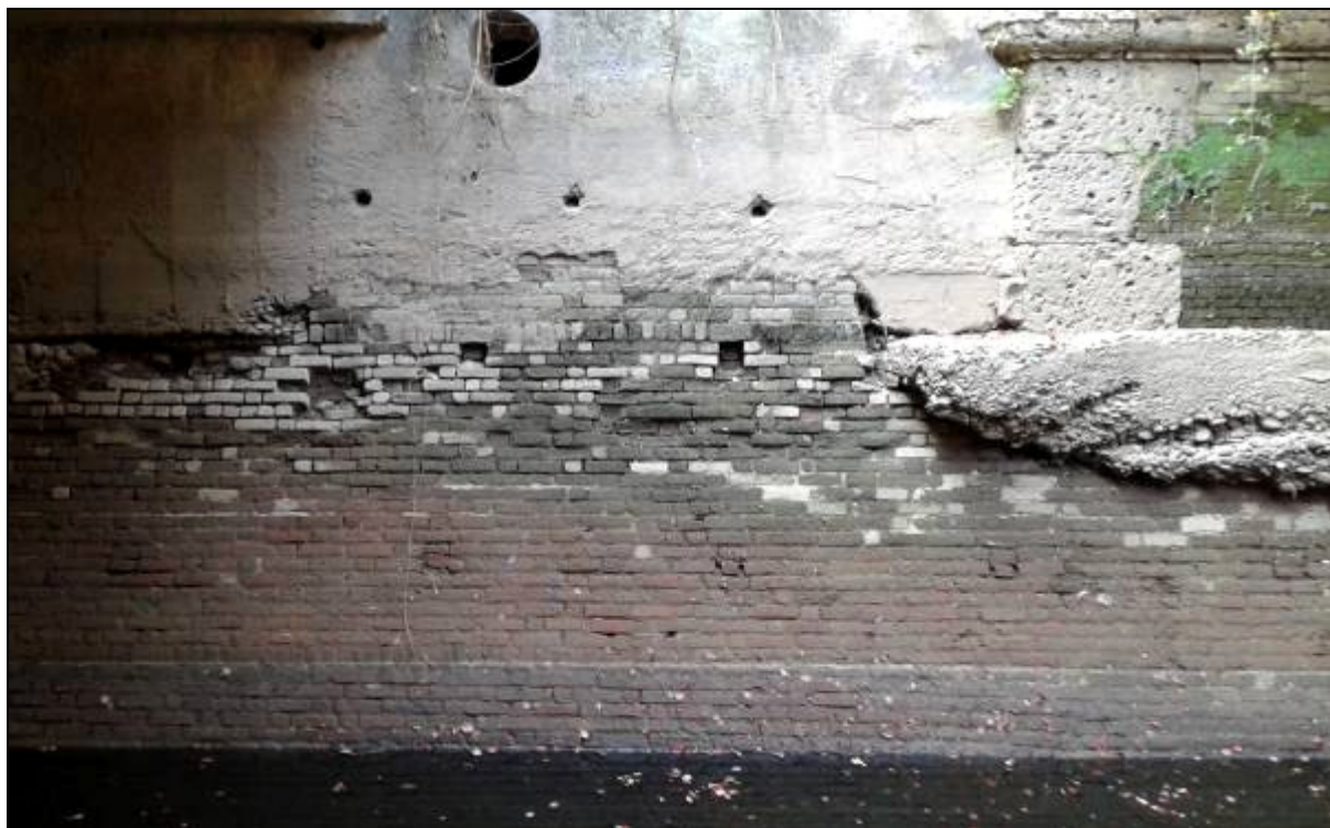
Fig. 41 - Alveo del fiume Lambro. Particolare del paramento in laterizi della base a scarpa delle mura orientali del castello, da E (foto S. Pruneri).
