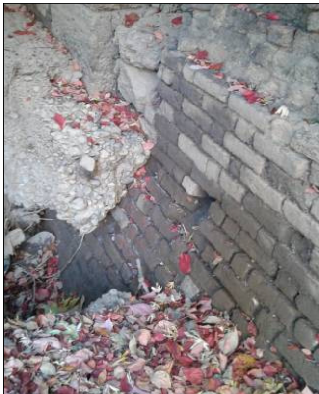
Fig. 43 - Alveo del fiume Lambro. Altro particolare della medesima struttura, da N (foto M. Malvaso).
