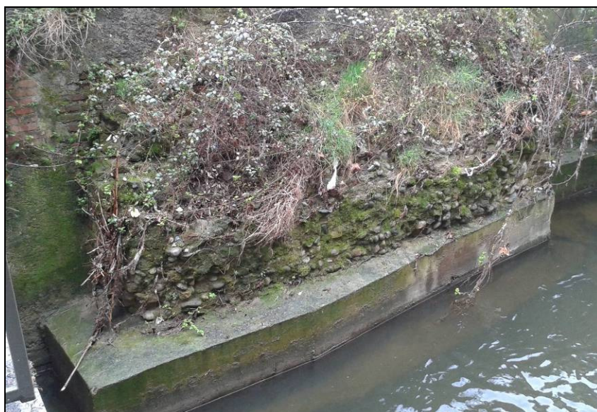
Fig. 4 - I resti della base di una delle torrette rompitratta appartenenti alla porzione orientale delle mura cittadine, ancora visibili lungo il corso del Lambretto, 40 m ca. a SE del ponte di via Lecco (foto S. Pruneri).
