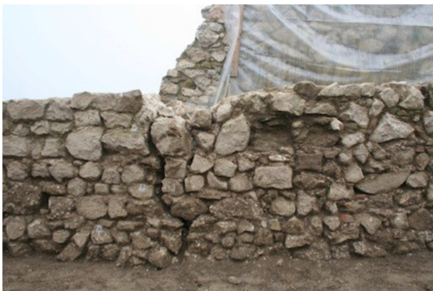
Foto tratto muro percorso di ronda particolare fratture sul crollo e fondazione
