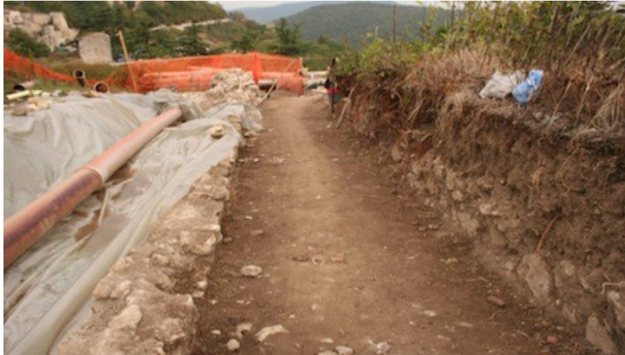
Piano di calpestio del percorso di ronda a valle del crollo
