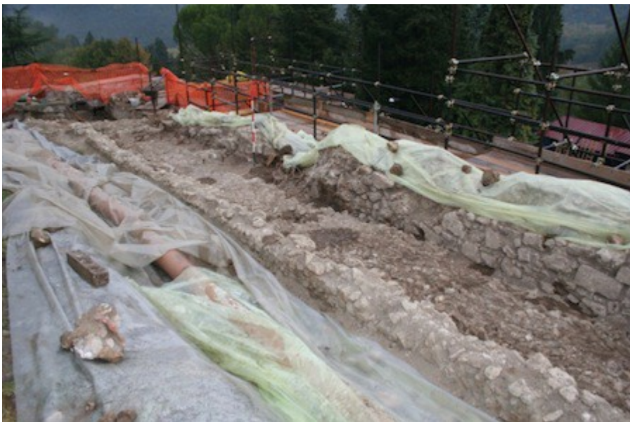
Percorso di ronda a valle del crollo, particolare
