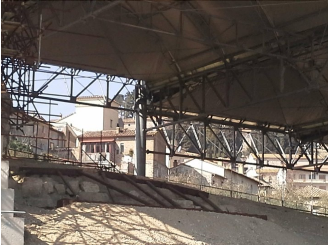
Foto del tratto di mura crollate e copertura futuristica
